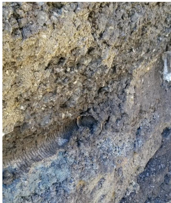
Figura 3-4. Estado actual del subdren presente en el tramo 1.
