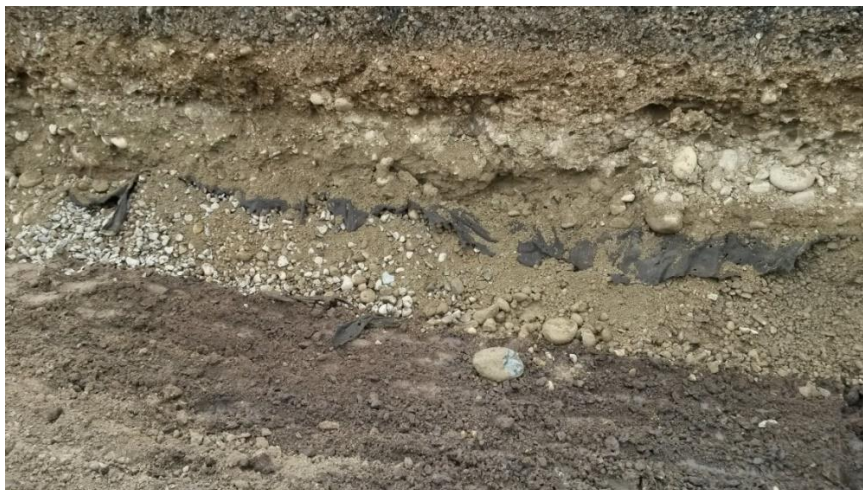
Figura 3-6. Estado actual del subdren presente en el tramo 2.
