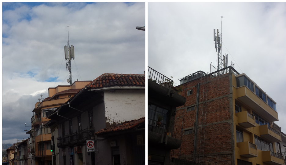
Figura 7.2: Antenas de Zona representativa 1 (Casco colonial).
