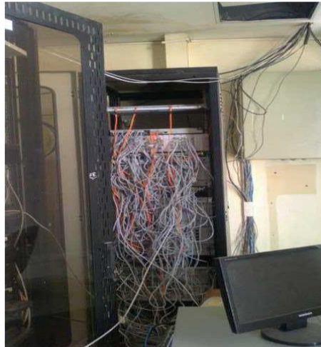
Fig. 1-2 Rack del Cuarto Comunicaciones del GAD de Loja
