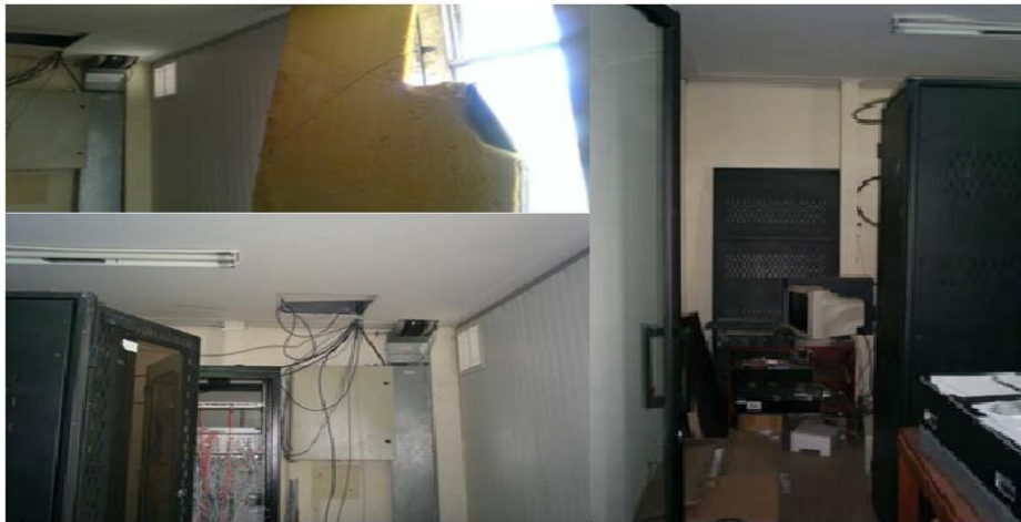
Fig. 1-1 Instalaciones actuales del Cuarto Principal de Comunicaciones.
