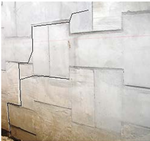
Foto. 45. Falla en mampostería propuesta. Con 40mm de deformación.
