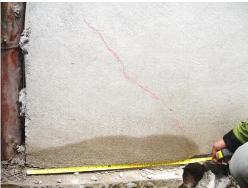
Foto. 42. Longitud desde la columna de apoyo hasta donde inicia la falla.
