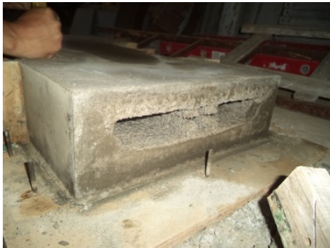
Foto. 26. Espacios vacíos sin presencia de mortero.
