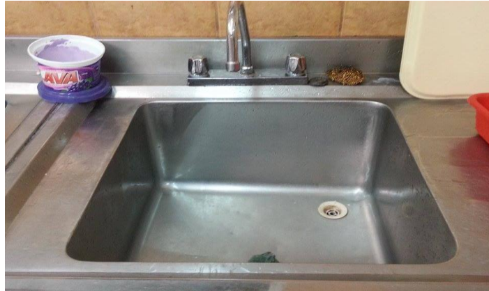
Ilustración 15: Pozo para el lavado de utensilios con riesgo de contaminación
