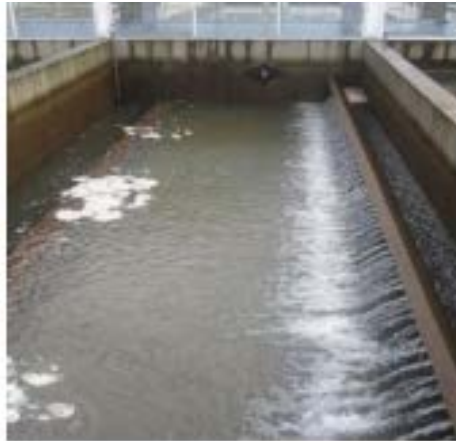
Imagen 6: Filtros (Planta de Sustag).
