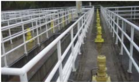
Imagen 4 a. Floculadores Mecánicos.
