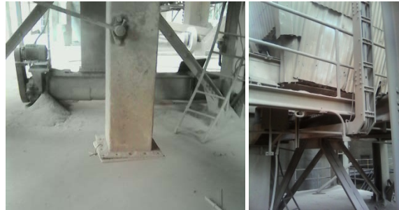
Fotos 26 y 27. Punto de muestreo N°14: Zona de medición para el polvo de crudo recuperado en la torre de enfriamiento del sistema molino de crudo-horno
