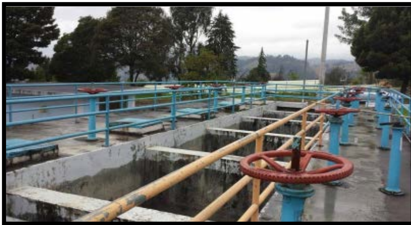
Foto 7: Unidades de Filtración - Planta de tratamiento de agua potable Uchupuncu.
