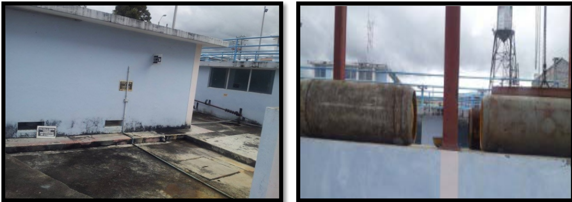
Foto 8: Tanques de Desinfección - Planta de tratamiento de agua potable Uchupuncu.
