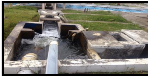
Foto 3: Conducción - Planta de tratamiento de agua potable Uchupucun.
