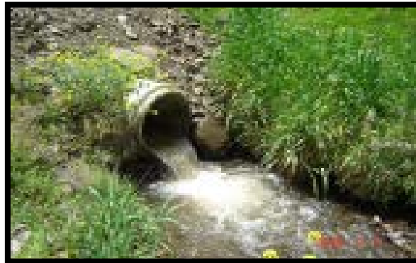
Foto 1: Captación de Condoryacu
