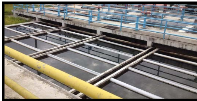
Foto 6: Unidades de Sedimentación - Planta de tratamiento de agua potable Uchupucun. Foto tomada por Autoras
