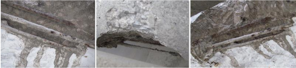
Ilustración 2.4 Problemas de exposición del refuerzo
