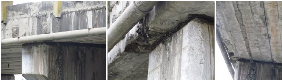
Ilustración 2.5 Problemas en las llaves de corte y en los apoyos de las vigas
