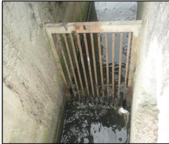
Figura 1: Rejilla de Entrada PTAR Quillopungo. Fuente: D. Alvarado & A. Cárdenas 2015
