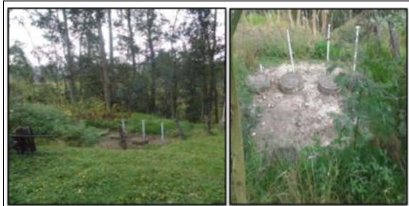
PTAR Octavio Cordero. Esta planta no cuenta con vía de acceso ni camino peatonal para ingresar a la planta. El ingreso se lo hace a través de un terreno de cultivo.
