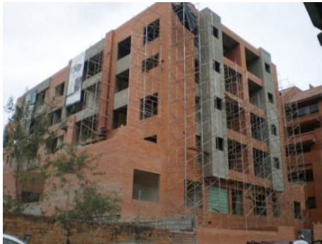
Foto 49. Edificio de seis plantas y dos subsuelos. Construido con Sistemas de Encofrados, la estructura es de hormigón armado y la colocación del concreto se realizó mediante camión mixer de concreto. Calle Víctor Albornoz.
