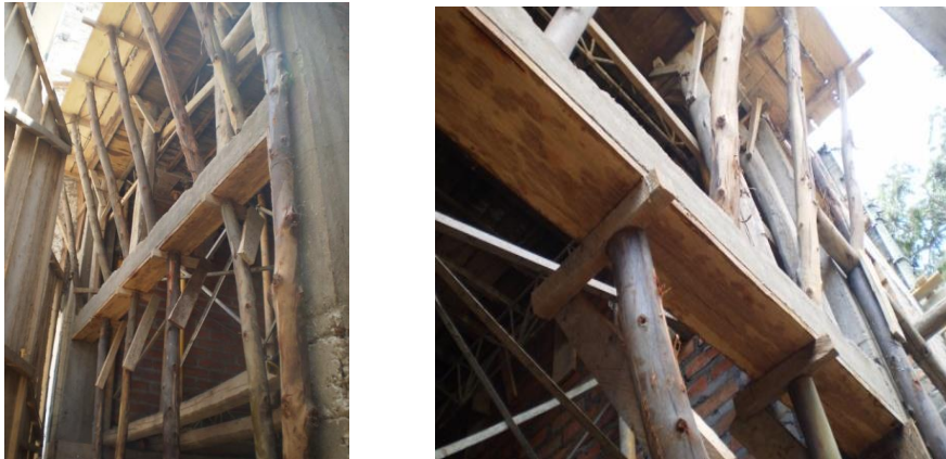
Foto 14. Apuntalamiento elaborado artesanalmente de madera, que conlleva una pérdida significativa de tiempo en comparación con el alquiler de puntales metálicos. Edificación de cuatro plantas, área de construcción 586 m 2 . Arq. Claudio Silva. Sector San Blas.
