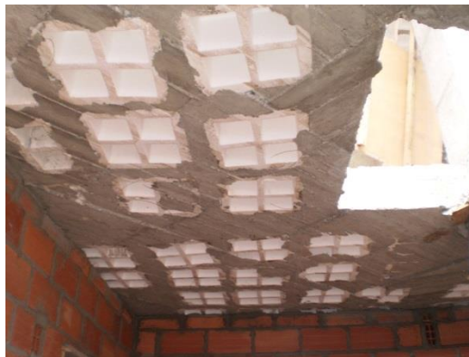
Foto 56. La losa de la edificación es losa nervada y la construcción se realiza con bloques de poliestireno expandido, que se queda en la losa luego de su fundición Arq. Boris Serpa. Sector el CREA.
