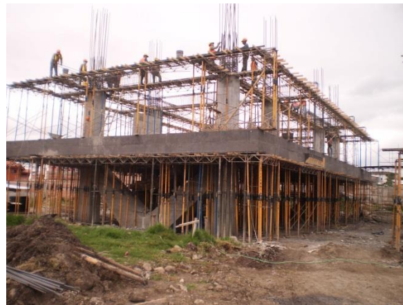
Foto 51. Edificación del “Centro Tecnológico de Balzay” de la Universidad de Cuenca. Construcción con Sistemas de Encofrados y colocación del hormigón mediante mixer de concreto.
