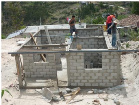
Foto 21. Vivienda de una planta, Parroquia Ricaurte. Arq. Calos Lasso. Área de construcción 100 m 2 . La estructura de hormigón armado ha sido elaborada de forma tradicional, con encofrados de madera armados en obra y mampostería de bloque, albañilería común.
