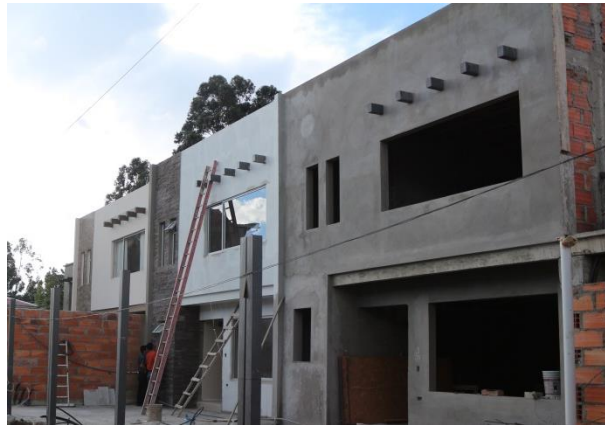
Foto 88. Tres viviendas de dos pisos con elementos prefabricados para losas, área de construcción de cada vivienda 160m 2 . Arq. Carlos Contreras. Calle Benito Juárez.
