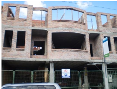
Foto 31. Vivienda de tres plantas, estructura con muros de albañilería confinada, con el empleo de encofrados metálicos para losa, y elaboración de hormigón In Situ. Área de construcción 414 m 2 , parroquia Sucre. Arq. Pablo Galarza.
