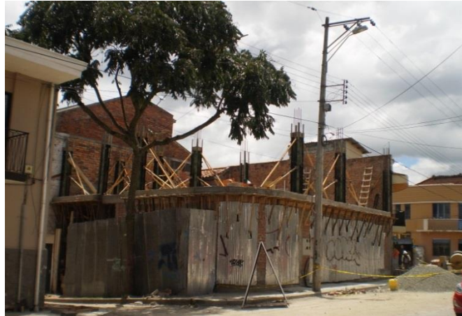
Foto 35. Construcción de edificación de cuatro plantas, en la Calle Manuel Vega. Estructura de hormigón armado, elaborado en obra, y con ayuda de encofrados metálicos para elementos estructurales. Arq. Claudio Felipe Silva. Área de construcción 586 m 2
