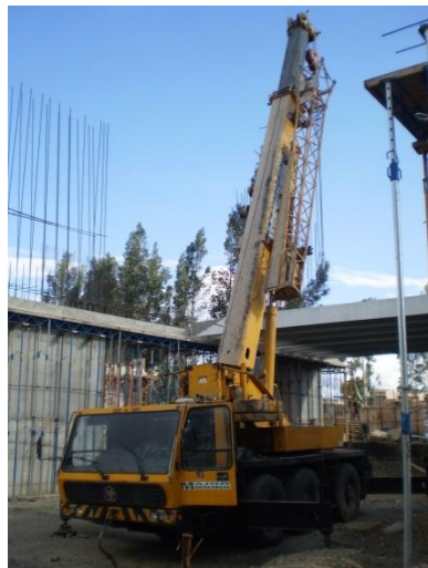
Foto 68. Grúa, medio de montaje utilizada para el izaje de losa de sección doble T. para la construcción del Edificio del Aulario para el “Centro Científico, Tecnológico y de Investigación Balzay de la Universidad de Cuenca”
