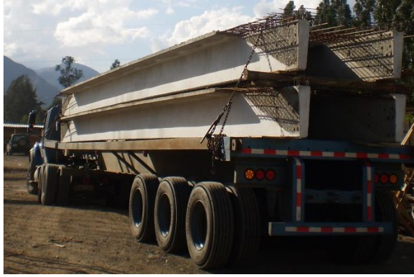
Foto 67. Plataforma para transporte de losas de sección doble T. para la construcción del Aulario para el “Centro Científico, Tecnológico y de Investigación Balzay de la Universidad de Cuenca”
