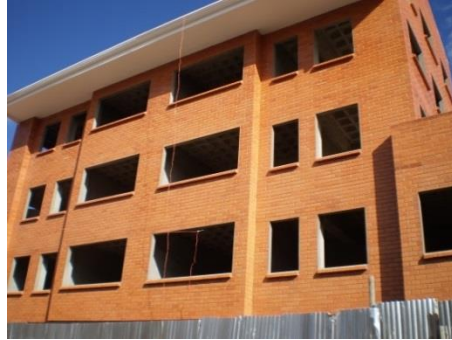
Foto 30. Edificación para uso residencial, de cuatro plantas, área de construcción 812 m 2 , en la cual se ha utilizada encofrados metálicos y el hormigón se ha elaborado en obra. Parroquia Yanuncay. Arq. Diego Contreras.
