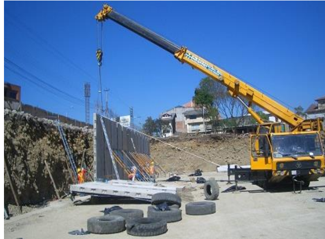
Foto 69. Proceso de montaje, de elementos verticales utilizados en la construcción del Parqueadero del Parque de la Madre en el proyecto: “Rehabilitación del Parque de la Madre”, que se realizó en el año 2012.
