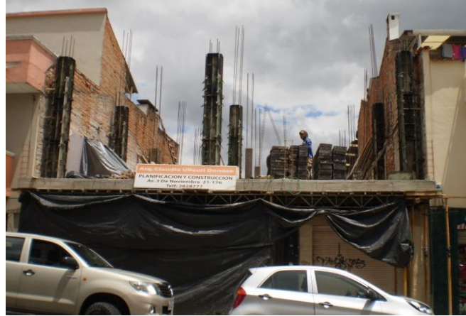
Foto 33. Edificación de tres plantas, construcción con estructura de hormigón armado, elaborado en obra y empleo de encofrados metálicos en elementos estructurales como columnas. Área de construcción 505 m2. Calle Juan Jaramillo. Arq. Claudio Ullauri.
