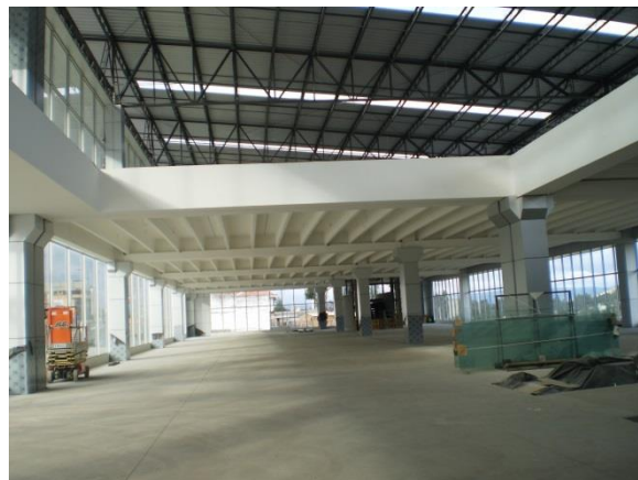
Foto 100. Espacio vacío en losa producto de diseño arquitectónico y estructural. Edificación de la “Ferretería Continental”.
