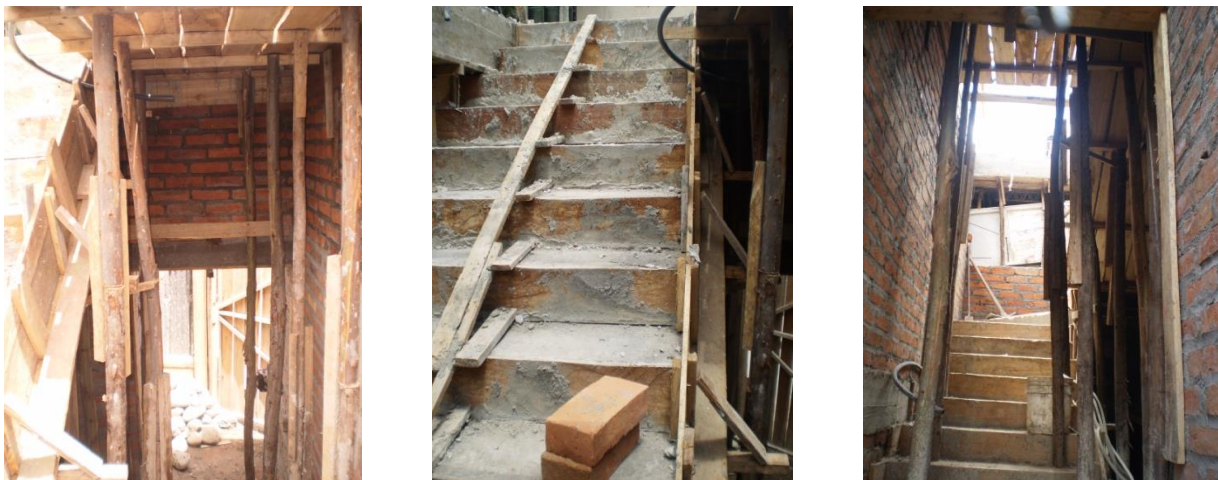
Foto 15. Encofrado de gradas, elaborado en obra, con puntales de madera. Edificación de cuatro plantas, área de construcción 586 m 2 . Arq. Claudio Silva. Sector San Blas
