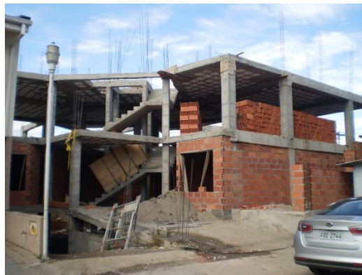
Foto 55. Edificación de estructura de hormigón armado, cuyos encofrados eran del Sistema de Encofrados metálicos y cuya aplicación del hormigón se realizó con la ayuda del camión mixer de concreto. La mampostería es de ladrillo. La edificación es de tres plantas y subsuelo, para uso residencial, área de construcción 1929 m 2 . Arq. Boris Serpa. Tiempo de ejecución de la obra un año ocho meses. Sector el CREA.
