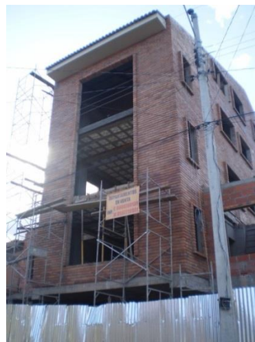
Foto 32. Edificación de cuatro plantas, estructura de hormigón armado, se emplea encofrados metálicos y el hormigón es elaborado y colocado en obra. Área de construcción 502 m 2 , parroquia Sucre. Arq. Daniel Jadán.
