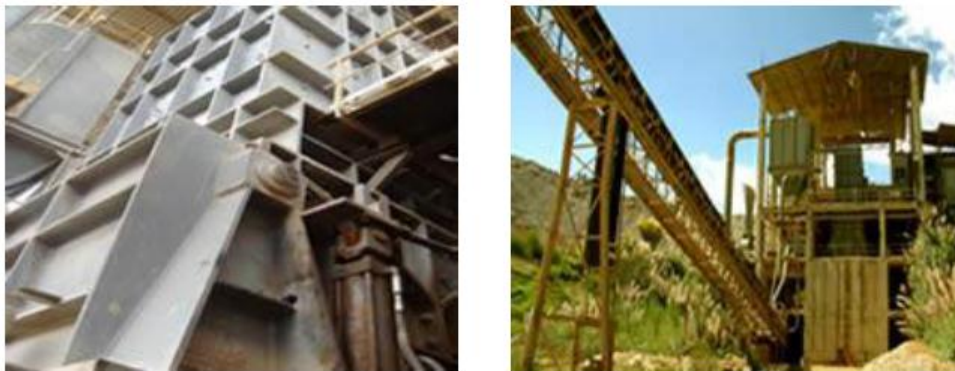
FIGURA 2. Imagen del Triturador de martillos. Imagen del área de trituración de materia prima. Fuente: Planta industrial Guapán.
