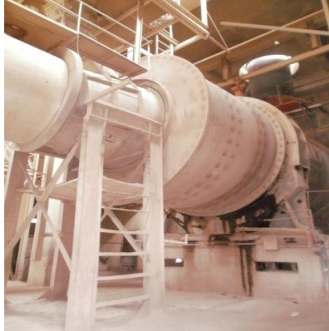
FIGURA 5. Imagen del área de molienda de crudo. Fuente: Planta Industrial Guapán.
