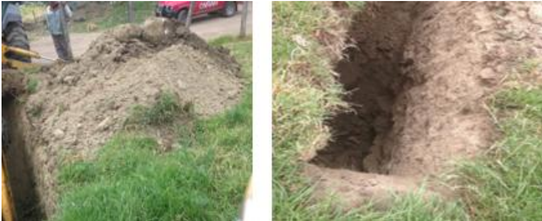
Foto 16. Excavación para el PCA 16. Ubicada en el sector del puente de Río Cañar.
