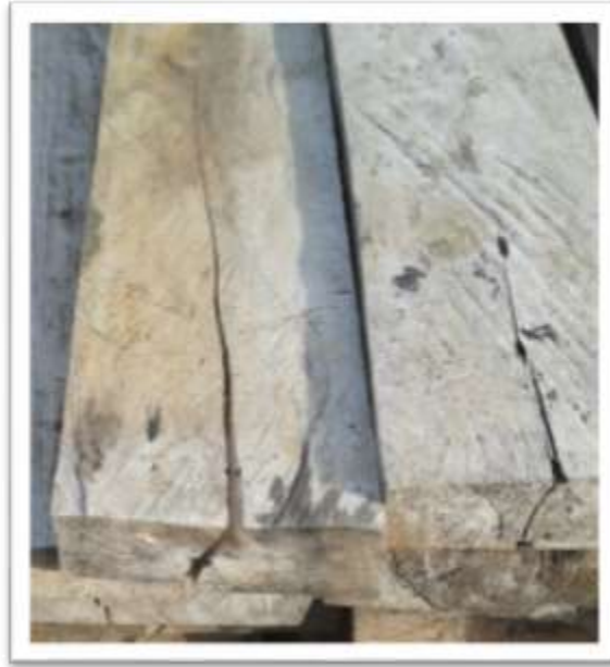
IMAGEN 23: Defectos propios de la madera “Grietas”
