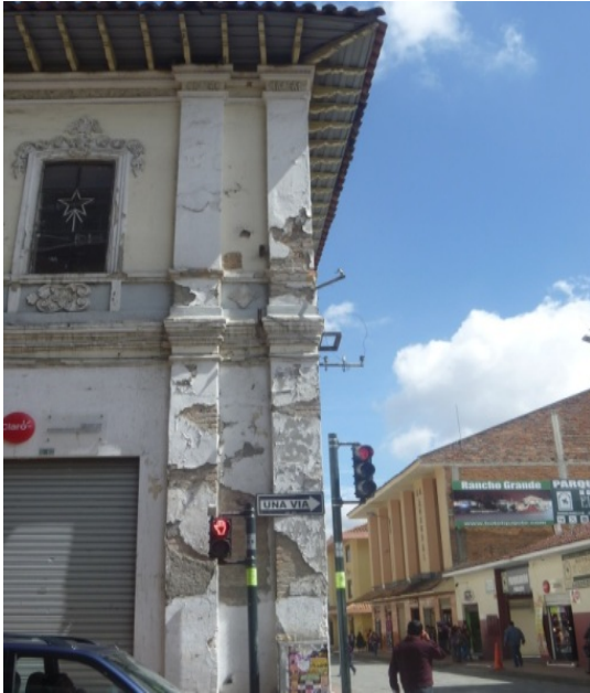
Edificio del Colegio Febres Cordero en descuido
