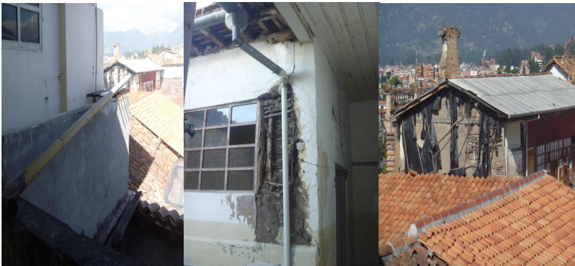
CONSTRUCCIÓN DE PAREDES SOBRE MADEROS NO PREPARADOS PARA SOPORTAR PESO
