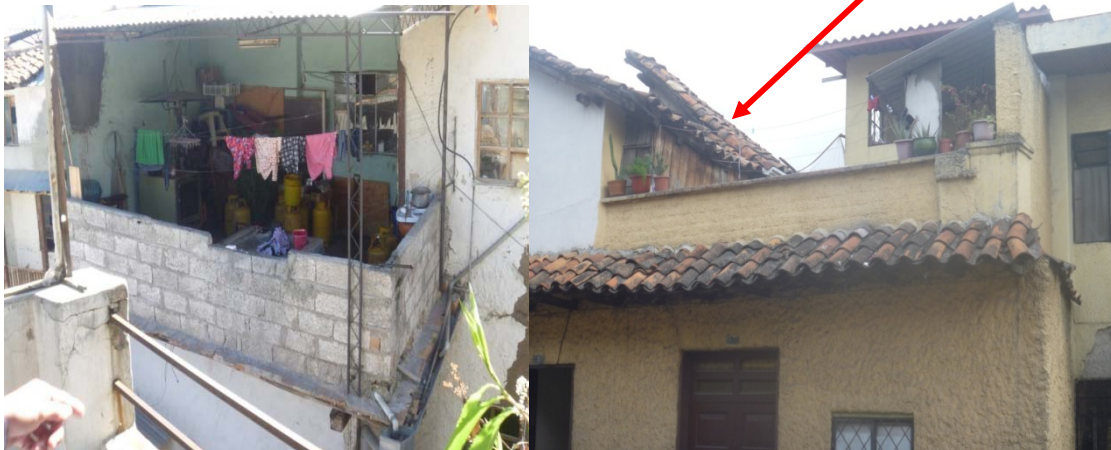
Evidencia de mala adecuación (montaje de Bloque sobre el Adobe)
