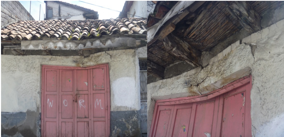
La falta de dinero y una adecuada reconstrucción provoca la autodestrucción Coronel Talbot y Presidente Córdova.
