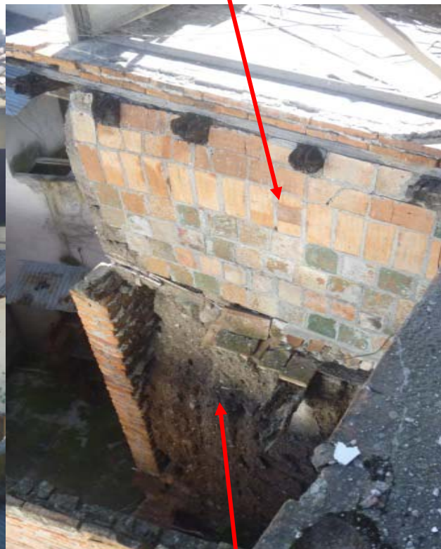
Abombamiento de la pared
