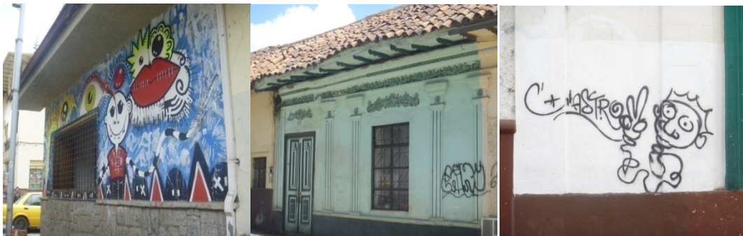
PAREDES MANCHADAS CON GRAFITIS (AGRESIÓN AL PATRIMONIO)
