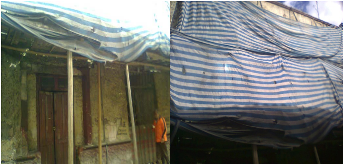
Edificación Municipal en total abandono ubicada entre las calles Tarqui, Larga y Pte. Córdoba
