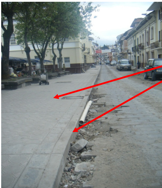
VEREDA y BORDILLO: EVIDENCIA DE MATERIALES PREFABRICADOS
