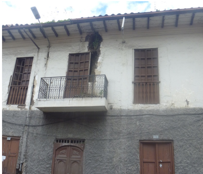
Gaspar Sangurima 10-78 (Casa en deterioro)
