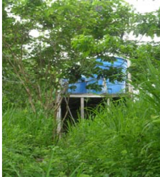
Tanque de agua pura
